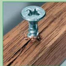
Spleißen des Holzes beim Eindringen durch herkömmliche Schraube.
