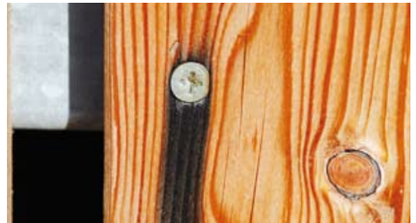
Hier wurden in einem harzhaltigen Holz Schrauben verarbeitet, die nicht korrosionsbeständig sind. Die Schrauben haben mit dem Harz reagiert und es kommt zu den schwarzen Streifen.
